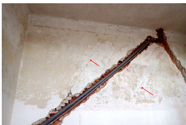
Obr. 4: 1. NP, tělocvična – stěna mezi tělocvičnou a kabinetem (č. místnosti 110).
