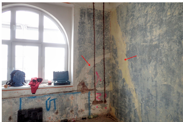
Obr. 6: 2. NP, kancelář (215) – trhliny v obvodové stěně a ve stěně u třídy č. 221.
