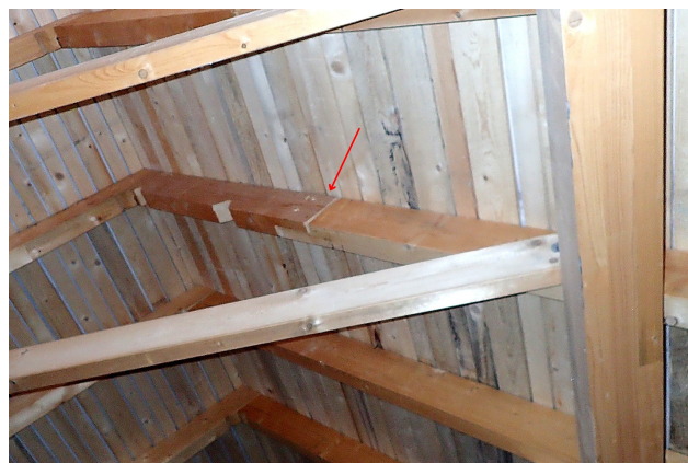
Obr. 11: Nová konstrukce krovu s nevhodně provedeným spoje krokve.
