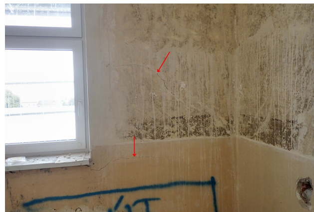
Obr. 9: 2.NP, třída (221) – trhliny v obvodové stěně nad průvlakem nad tělocvičnou.
