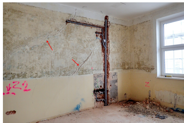
Obr. 7: 2. NP, třída (221) – trhliny ve stěně u kanceláře (215)
